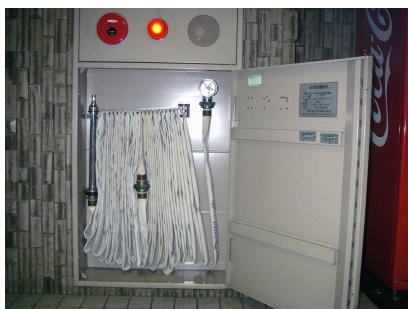
1号消火栓（2人以上で操作）
